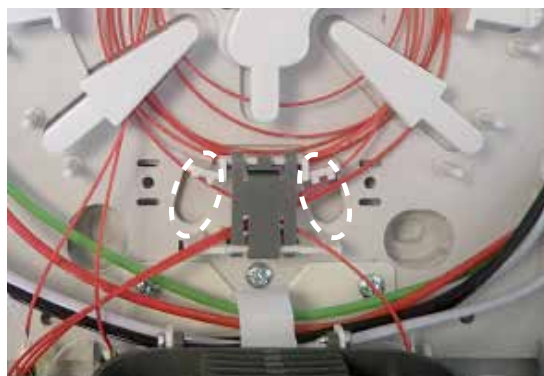
Fig. Passage de câbles en configuration loosetube Cable routing - loosetube configuration
